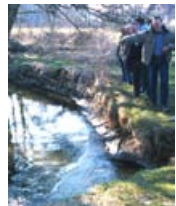
▲ Ufererosion kann Teil der natürlichen Entwicklung eines Gewässers sein.
